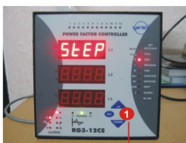
เข้าสู่โหมดตั้งค่า Steps Capacitor Bank 1 - 12 Steps
